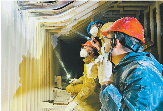
永州公司职工检查气-气换热器弯头磨损情况。
