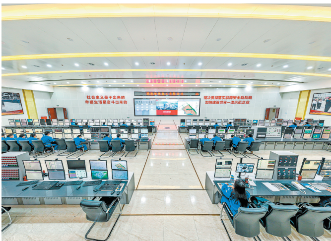
榆林化工中心控制室。
