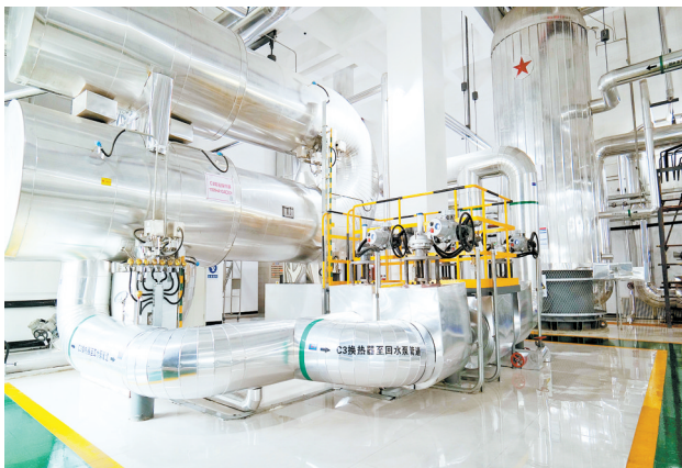
龙山电厂抽汽熔盐储能C3熔盐换热器。
