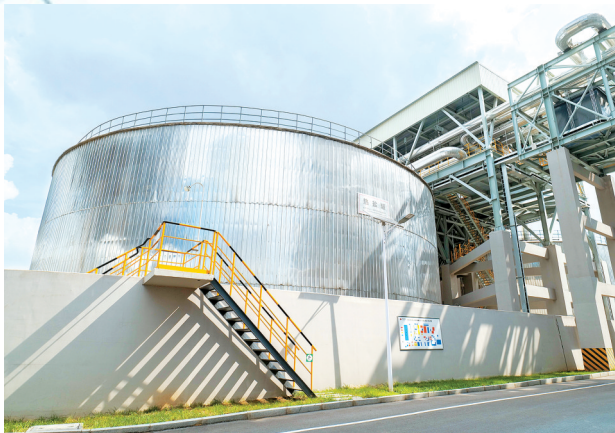
龙山电厂抽汽熔盐储能热盐罐。
