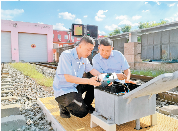
QC小组成员在信号机灯端测量电压。
