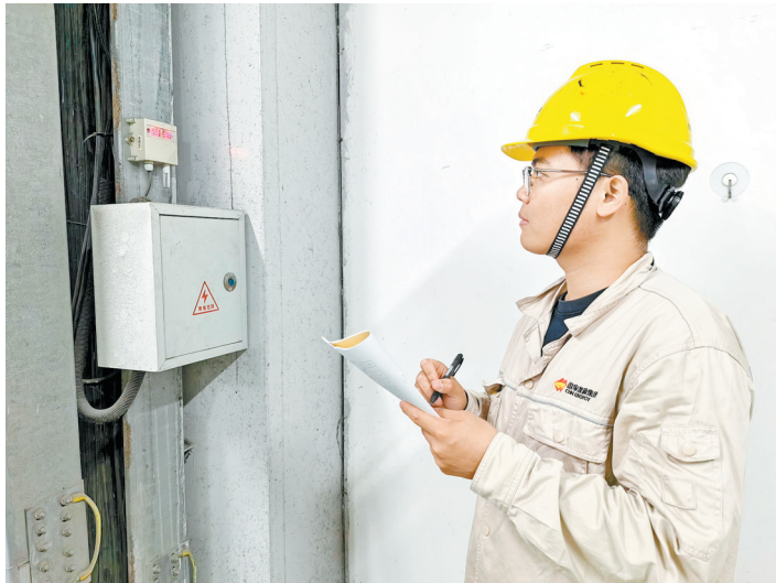
连日来,受台风影响,宿迁地区出现持续性降雨。江苏宿迁公司迅速开展电气设备雨后专项巡检,防范阴雨高温天气引发的设备受潮、短路、漏电等隐患,筑牢汛期机组安全运行防线。图为8月14日,运行人员记录凝泵变频器室湿度。 本报通讯员 蔡宇 摄
