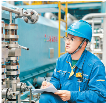
大图:煤液化反应加温炉。 小图:操作人员记录机泵润滑油温度。
