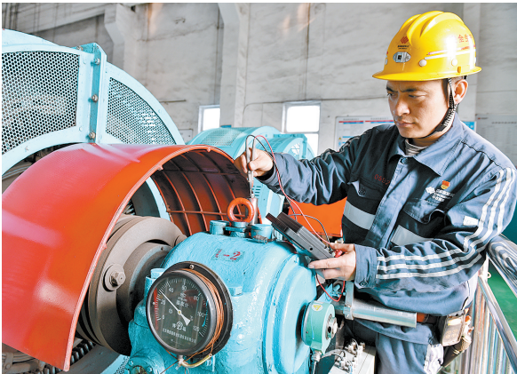
李磊点检副井提升系统电机运行状态。
