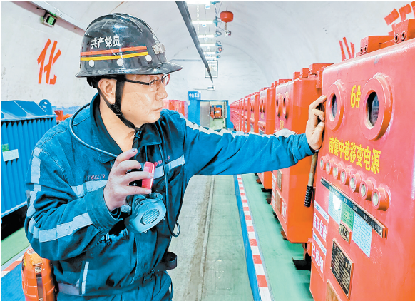
刘占军检查井下机电设备运行状态。
