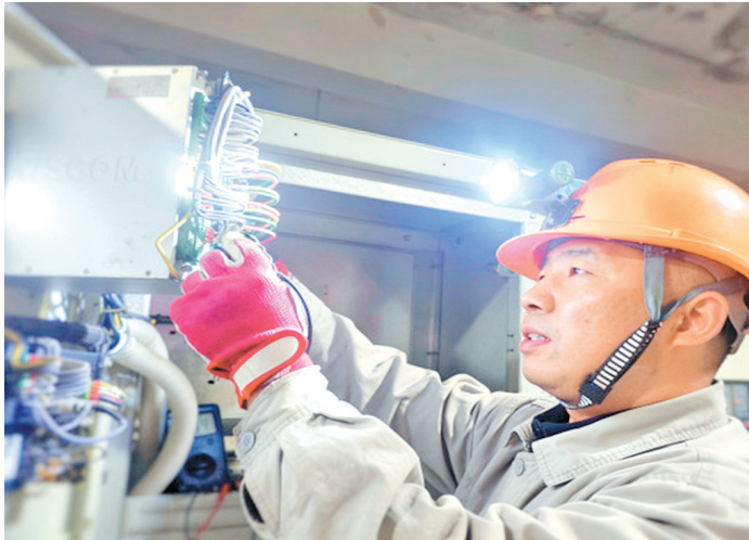
吕明峰在处理高压开关故障。
