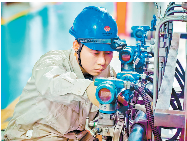
▲连日来，乌海市持续38℃至39℃高温。西来峰公司结合循环流化床机组夏季运行特点，精准施策、精细运维、精心保障，规避高温设备风险，保障机组安全稳定运行，平稳应对酷暑考验。图为7月8日，图为热控检修人员检查压力变送器外观及供电情况。 本报通讯员 郭佳 摄
