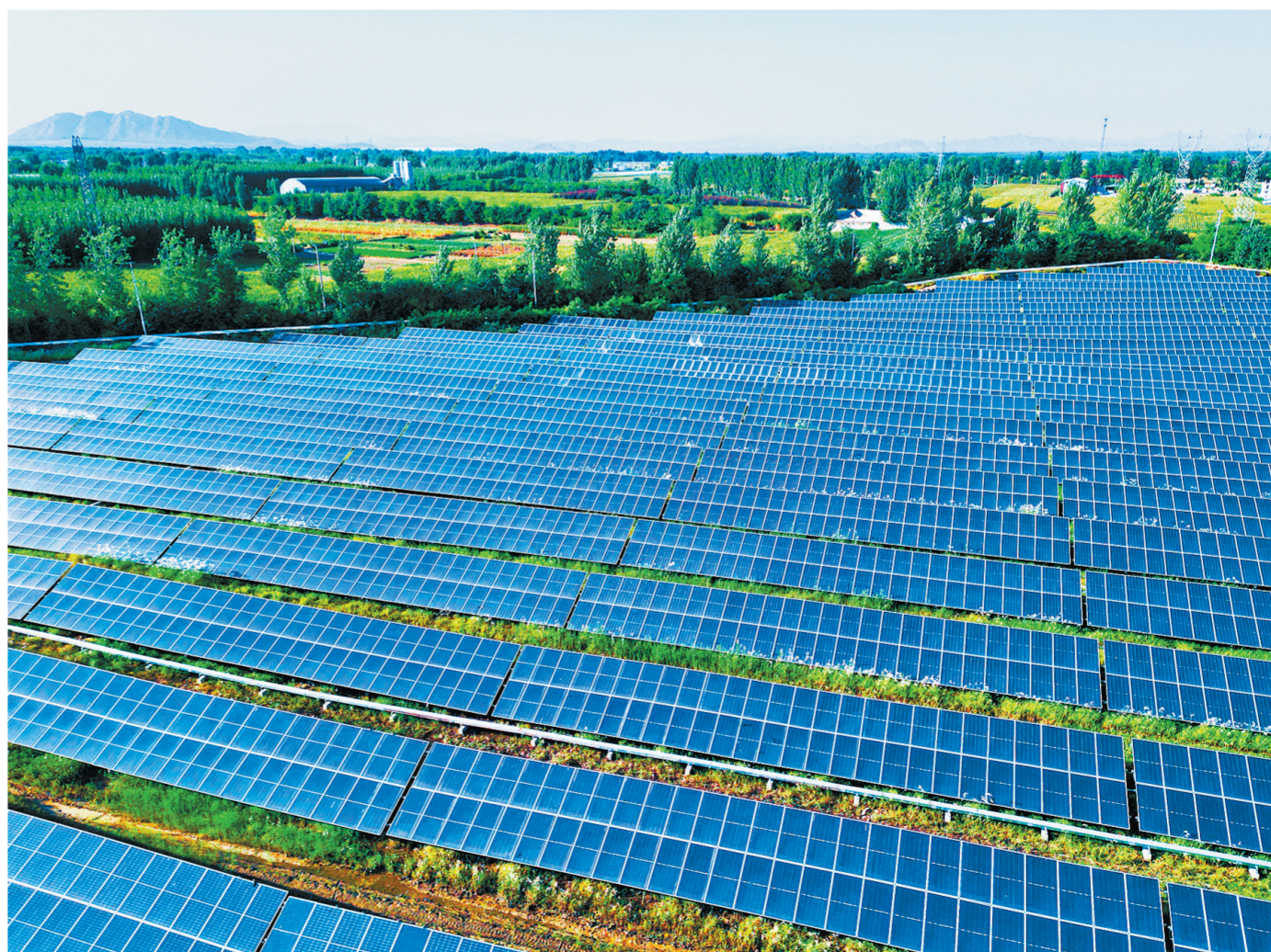
上半年，河北公司光伏项目累计发电量1.69亿千瓦时，安全生产持续稳定。今年以来，该公司多措并举抓实光伏设备运维工作，常态化巡检光伏组件、逆变器、升压站及集电线路，及时消除各类安全隐患，筑牢发电安全屏障。图为定州电厂孟家庄光伏电站（摄于6月20日，无人机照片）。 本报通讯员 李永杰 摄 特约记者 吴威威 文
