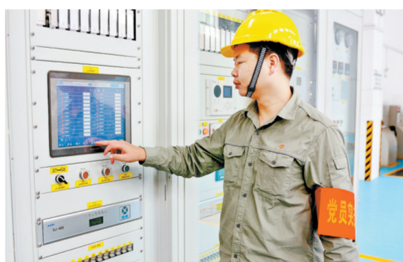
↑6月29日，湖北公司南河电厂“党员突击队”队员巡视机组设备。
