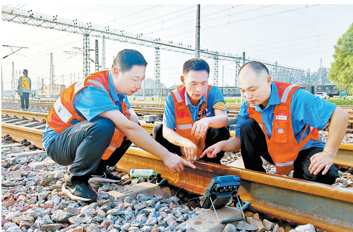
↑6月26日，朔黄铁路肃宁分公司线桥检修中心党员测试钢轨试验数据精调作业。
