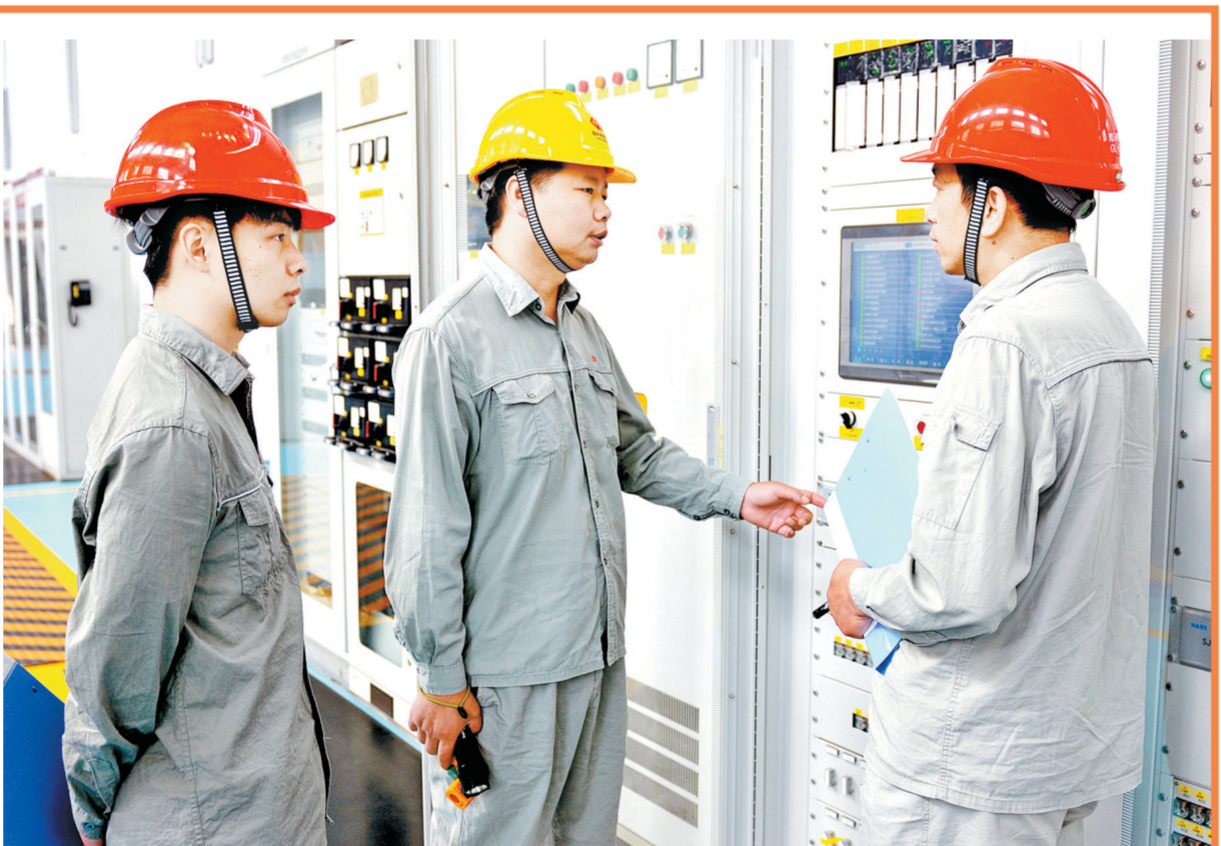
← 福建龙岩公司抓实设备巡检工作，清晰划定检查重点、细化检查标准、强化现场巡检管控，对巡检数据及时整理比对、综合分析，提前排查治理设备隐患与各类异常，全力保障机组安全稳定运行。图为6月23日，检修人员检查除氧器水位计。 本报通讯员 廖艳萍 摄
