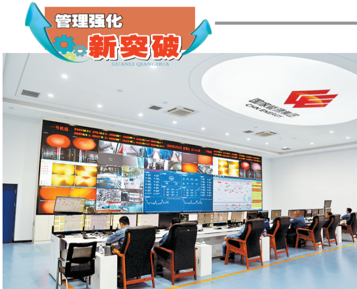
6月22日起,吉林江南公司将脱硝除灰、化学专业并入主集控室,开启集控运行新模式。新模式打破主辅专业壁垒,运行人员可同步研判全系统工况,设备异常时可实现就地沟通、快速处置,水质管控、脱硝脱硝联动、负荷调整等环节效率显著提升。因为当日优化调整后的主集控室。 本报通讯员 孙国峰 郭立彬 摄
