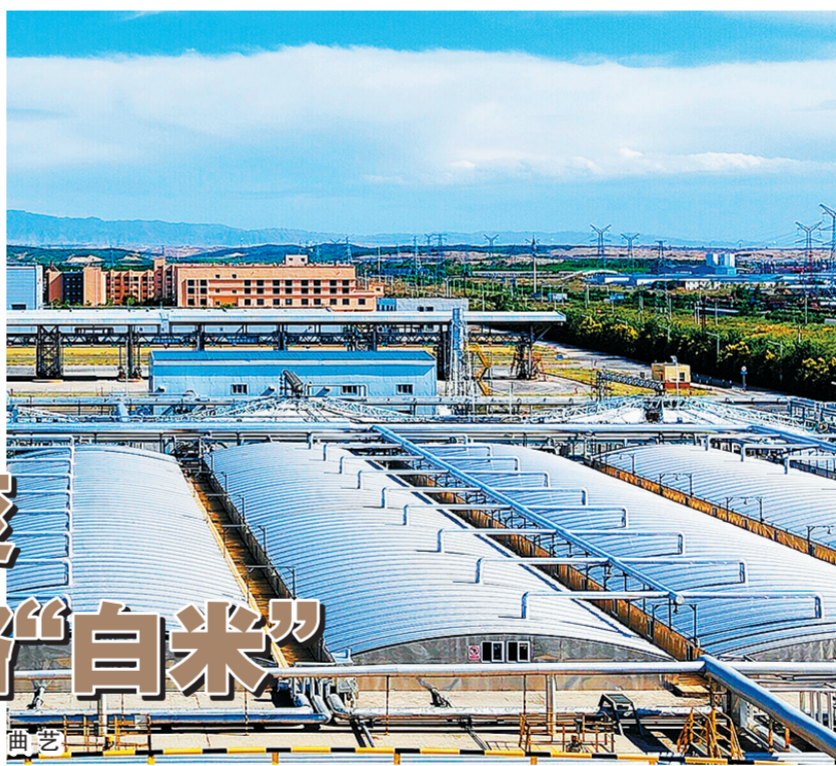
大图为标准化污水处理系统实景图。 小图为职工现场核验聚烯烃产品，精细化把控产品各项质量指标。
