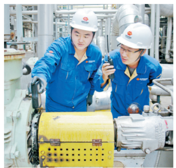
大图为厂区核心化工净化装置。 小图为职工认真检查罗茨风机振动情况。
