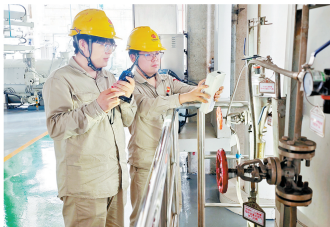
煤粉取样管阀门漏粉情况。安徽公司池州电厂运行四值职工排查
