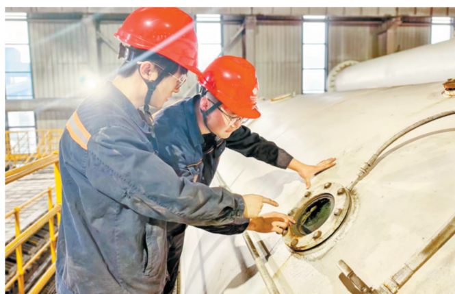
车间职工观察加压过滤器排料情况。神东煤炭洗选中心哈拉沟选煤厂末煤
