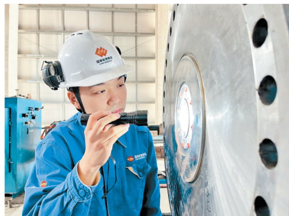
6月11日,包头化工开展隐患排查整治工作,重点核查设备安装质量、工艺合规性等内容,精准梳理各类问题短板。发现问题,严格落实清单化管理,筑牢隐患排查治理闭环体系。图为岗位人员检查压缩机联轴器。
