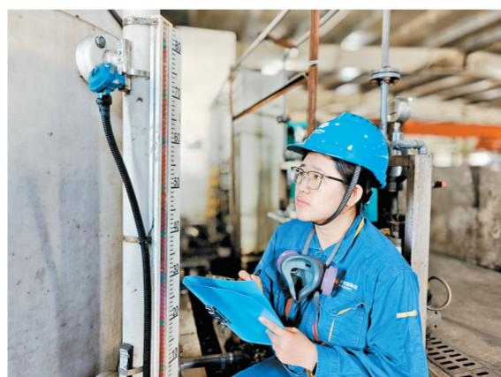
6月11日,新疆化工运行人员检查煤水提升泵控制柜运行情况。近日,公司深入开展隐患排查整治工作,运行人员严格执行巡检规程,逐项核对运行参数、排查电气线路隐患、测试联锁保护功能,确保设备状态可控。
