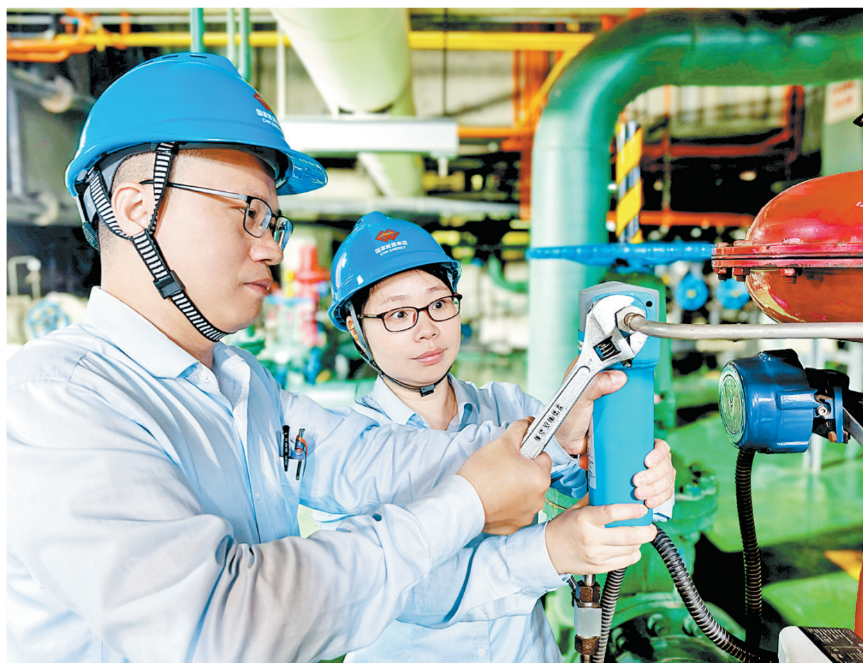
面对近期持续性高温天气,福建龙岩公司加强对重要设备的“把脉问诊”,重点对电子设备、制冷系统、油管道等进行检查,及时发现设备存在的缺陷隐患并予以消除,严防设备“带病”作业,有效提高设备可靠性,为机组安全稳定运行提供保障。图为5月27日,检修人员更换阀门定位器气源控制筒。
