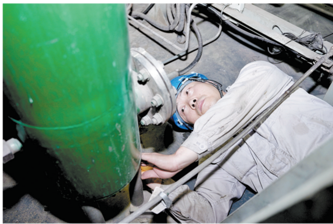
孙策检查定子内冷水口滤网排污管。
