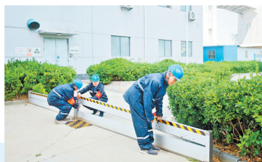
5月10日,山东泰安公司开展防汛防台应急演练,演习人员在厂区关键位置安装防汛挡水板。 本报通讯员 王丽 摄
