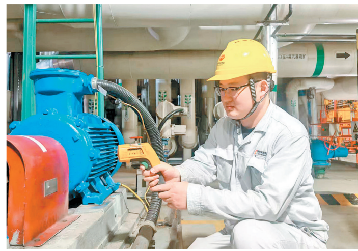
随着气温升高，河南民权公司持续深化隐患排查治理，常态化开展安全风险排查，加强对转动设备、压力管道、电气设备等重点部位的“拉网式”排查，重点检查设备温度、振动等运行状态。针对排查发现的问题，建立隐患台账，明确整改措施，筑牢安全生产防线。图为5月6日，运行人员测量定冷水泵运行温度。
