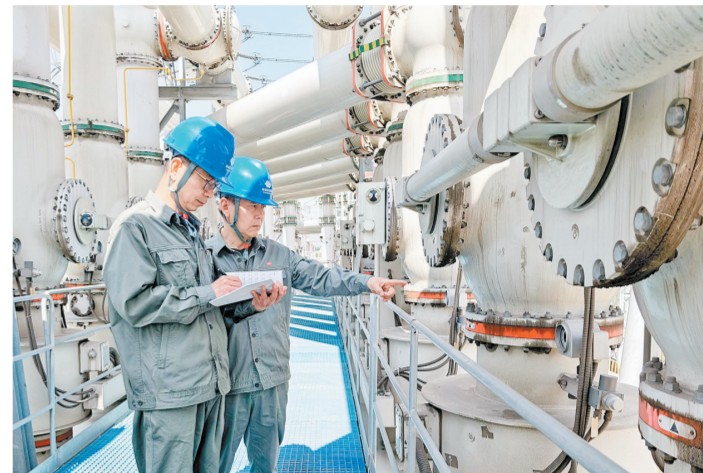
为保障涉网设备平稳度夏，山西神二公司优化日常巡检方案，将高温、雷雨、夜间、双休日等时段专项特巡加密至每日至少3次，重点对刀闸触头、互感器、避雷器、变压器套管端头等核心部位进行巡视测温，同步排查处理设施密封缺陷，并通过数据研判精准把控设备态势，真正实现问题早发现、隐患早排查、缺陷早处理，全力筑牢夏季电网安全防线。图为5月7日，工作人员对站内设备进行检查。
