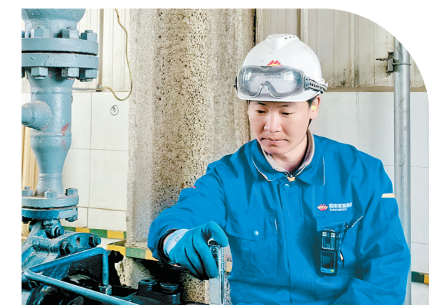
刘家检查甲醇合成装置机泵振动情况。
