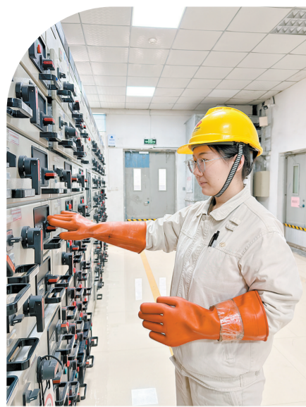
辛瑞在灰硫主VOCs配电室进行送电操作。
