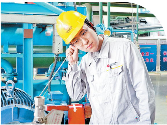
李伟源使用听针检查循环水升压泵运行工况。
