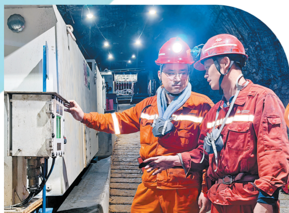
工作面电器列车运行情况(张新宇左)和同事一起查看综采
