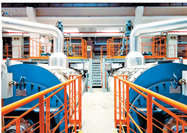
国内首个大型燃煤机组环保污泥耦合掺烧项目的污泥处置车间。
