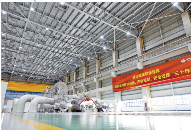
入选国家能源局第一批新型电力系统建设能力提升试点名单的4号机组。
